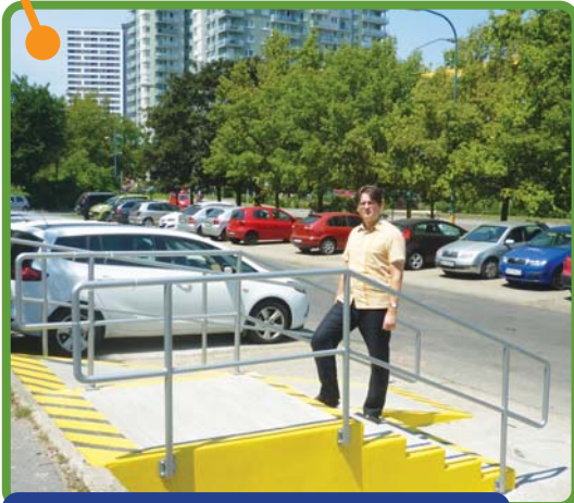
Oprava schodísk (aj pre ZTP osoby), zábradlí, múrikov a terás (napr. Šustekova, Mlynarovičova, Lachova, Blagoevova ul.)
