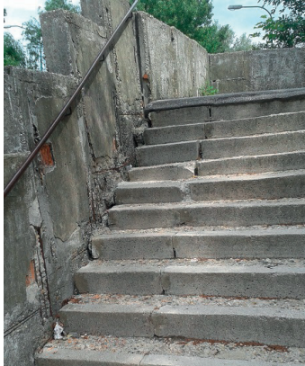
Zdevastované schodisko vedúce na terasu na Strečianskej ulici.
